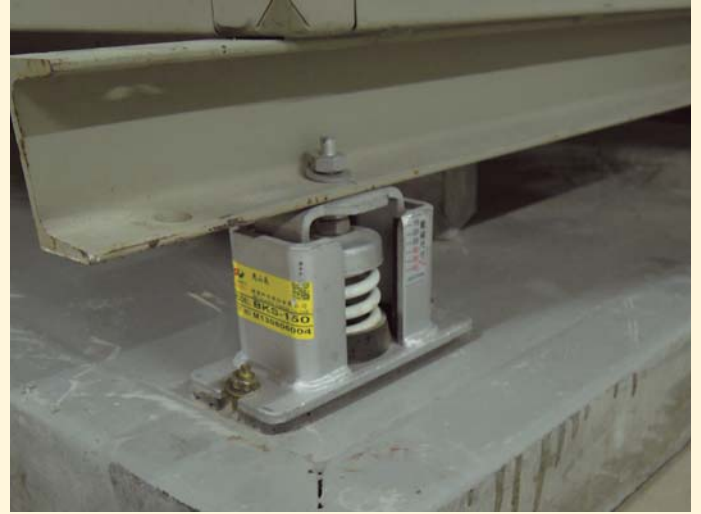
風機槽鐵基座搭配BKS
